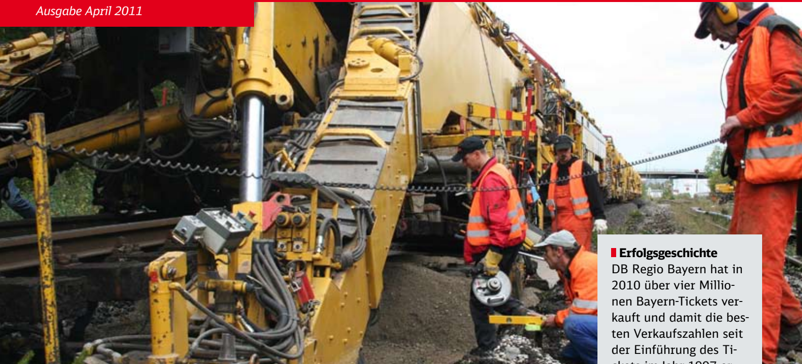
Stammstrecke: Riesige gelbe Maschinen wechseln die Schienen und Gleise zwischen Ostbahnhof und Pasing aus.
